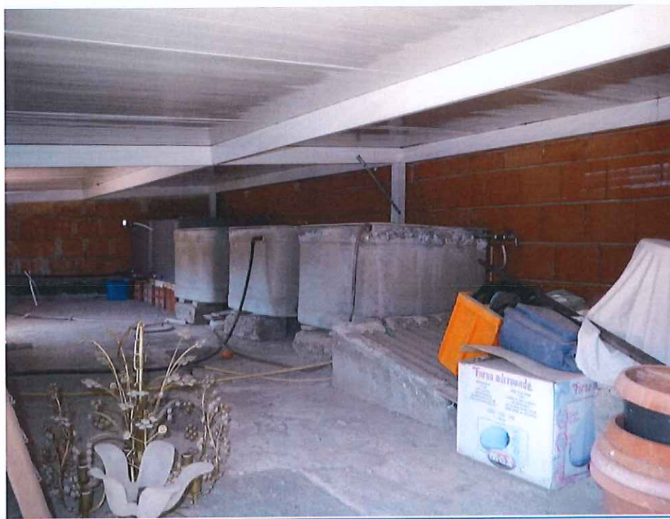
Locale Tecnico a P4 soprastante il locale magazzino a P3
